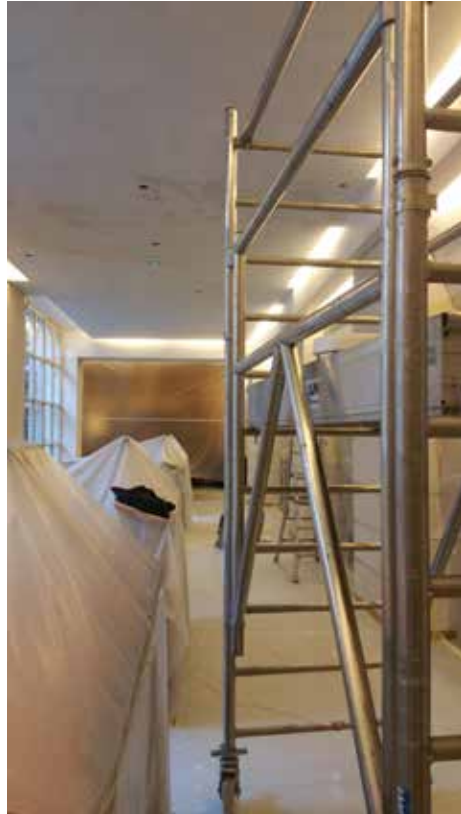
Renovierung des Lesesaals im Dezember 2017 nach dem Wasserschaden durch Starkregen
